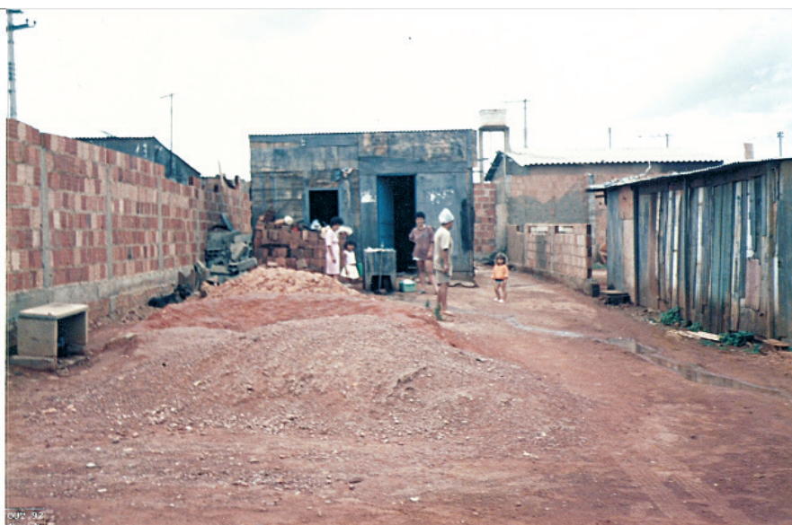
Figura 64 Instantáneas de la época de la construcción de las casas en Santa Maria, con las primeras zanjas que irían a impulsar el nuevo sistema de desagües
