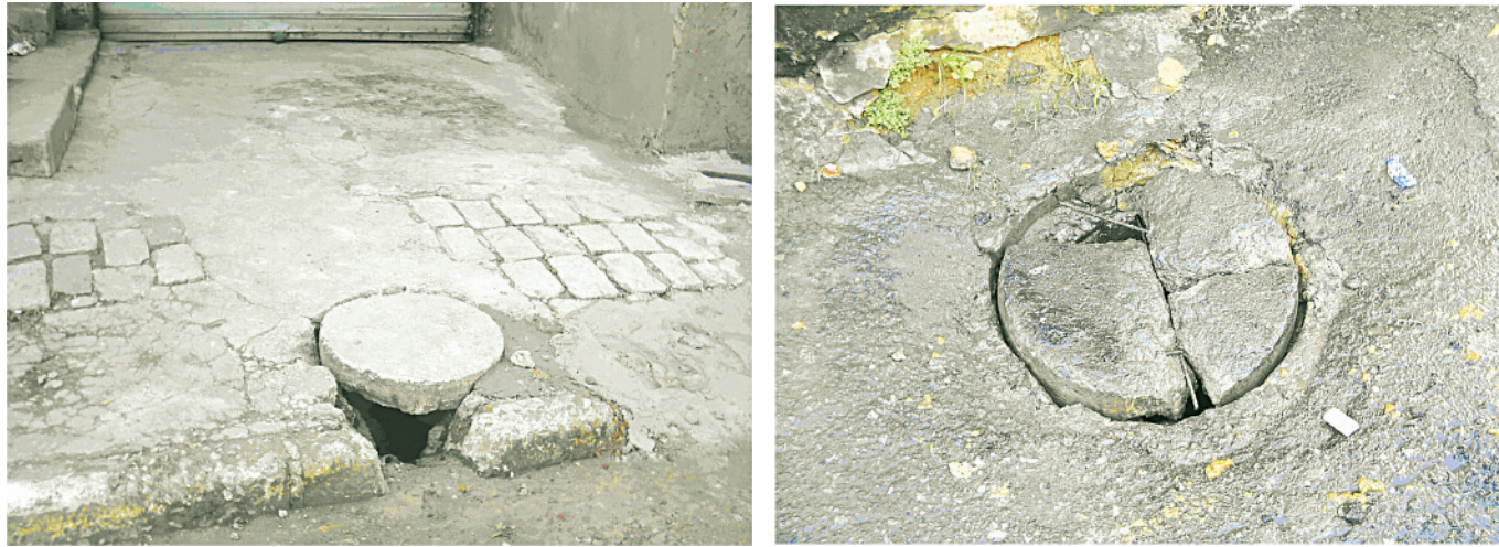
Figura 84 El gran número de roturas de tapas de las inspecciones del sistema de desagües como una forma más de penetración de las aguas pluviales. Fuente: Archivos del ingeniero Ivan Paiva
