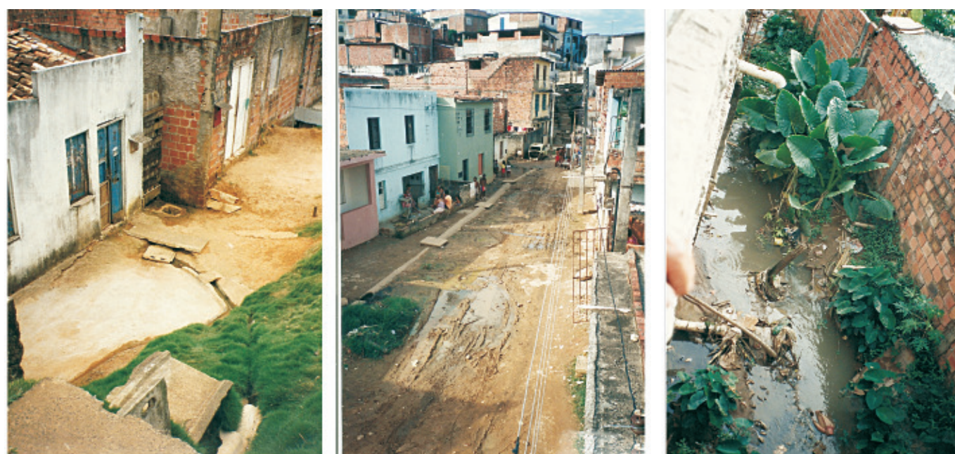
Figura 77 Los sistemas unitarios de Salvador son muy precarios del punto de vista sanitario y, además de ello, son serios obstáculos para el suceso del sistema separador
