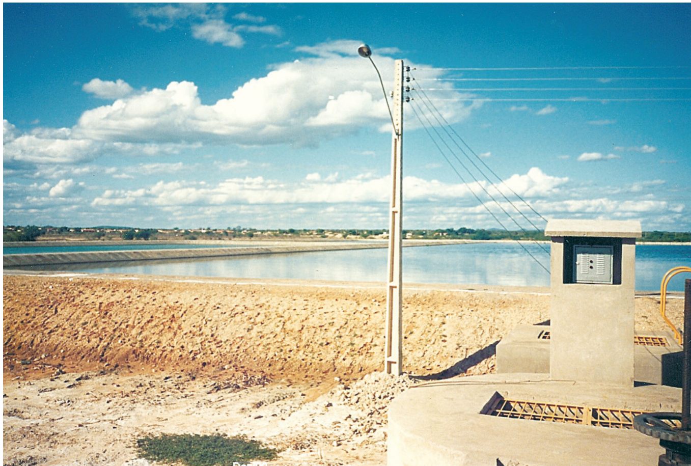
Figura 62 Una de las 11 lagunas de estabilización de la ciudad, en este caso conforme al diseño convencional
